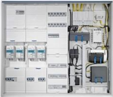
Technikzentrale DIN 43870 und DIN VDE 0603
